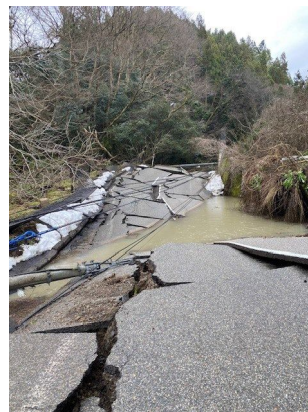
国道249号 被災状況3
