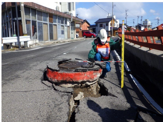
下水道施設(雨水渠)の被害状況3
